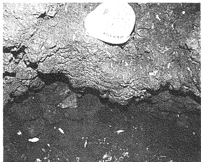
最下部のガス溜り部
