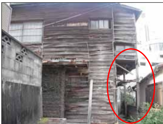
柱の数箇所に破損がある例
