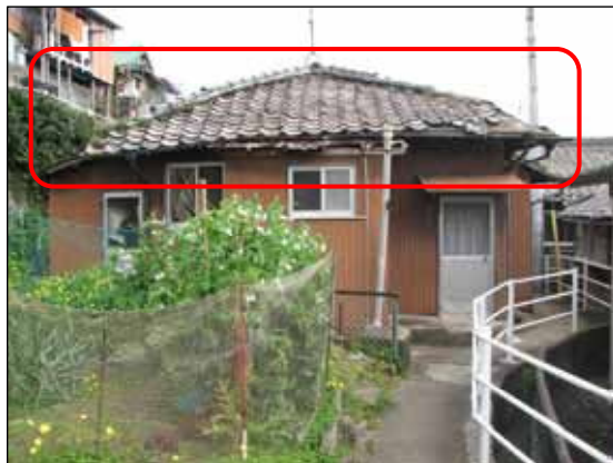
屋根に不陸がある例
