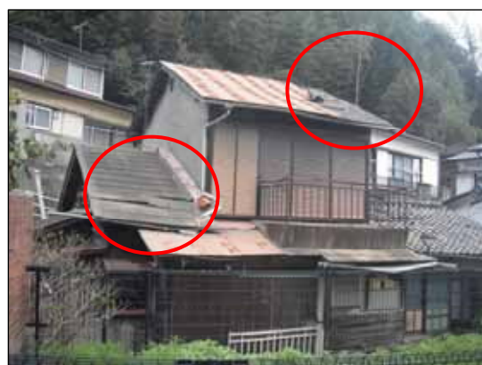
アスファルト屋根等の一部に ズレがあり、雨漏りのある例
