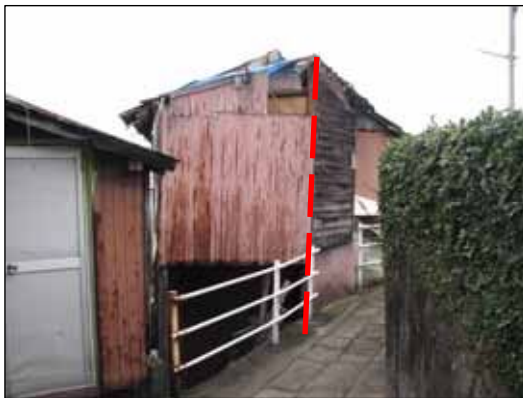
一部の柱が傾斜している例
