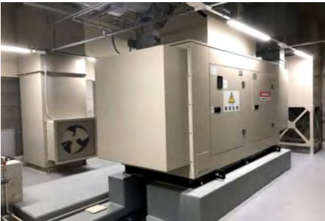
非常用発電機イメージ
