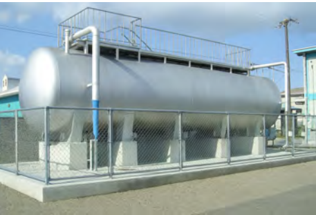
耐震性貯水槽イメージ
