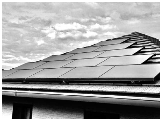
補助制度がある太陽光発電設備
