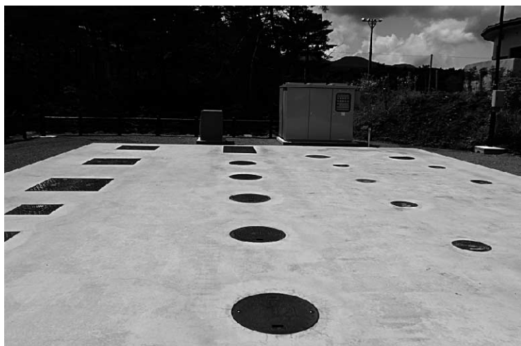
災害用トイレが設置できる道の駅なるさわの浄化槽（博物館南側）
