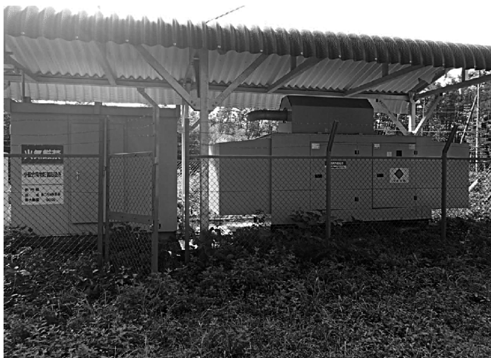
三本松水源の非常用自家発電装置
